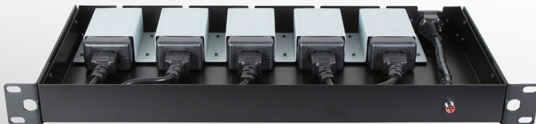
MPC-100 instalado con PSU de los receptores.
